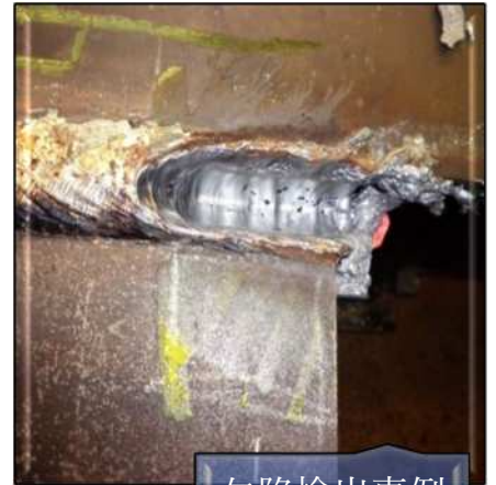
欠陥検出事例
